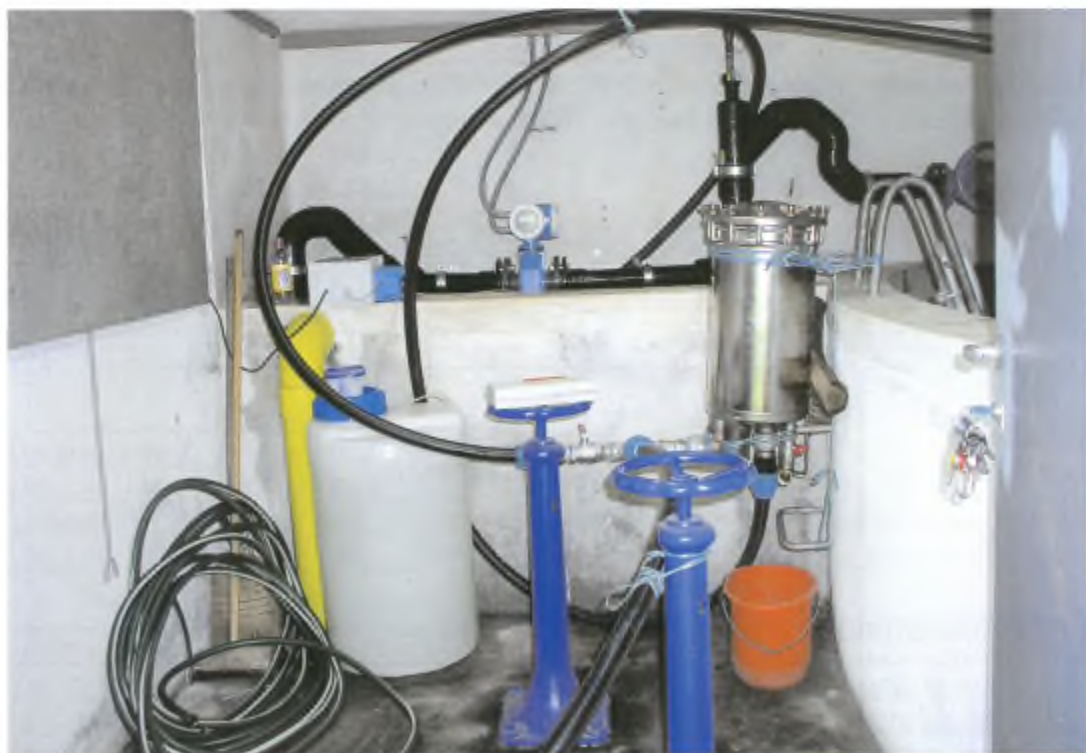
Impianto di filtraggio e clorazione dell'acqua del riale Riazzino, nel serbatoio Bugaro 1.
