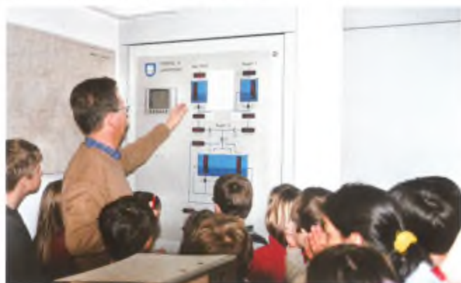
Il tecnico Alessandro Pisoni ci mostra il pannello di controllo dei quantitativi di acqua potabile.
